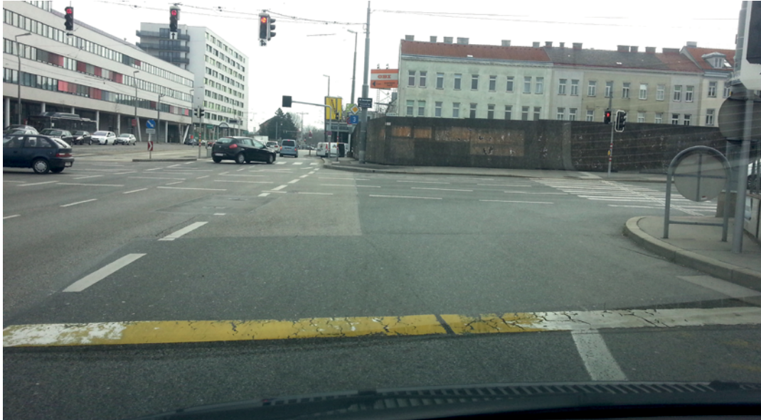
Abbildung 5: Alte Bodenmarkierungen, durch Abnutzung sichtbar
